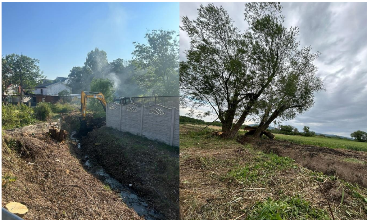
Rów R-N1 obręb Wirki
