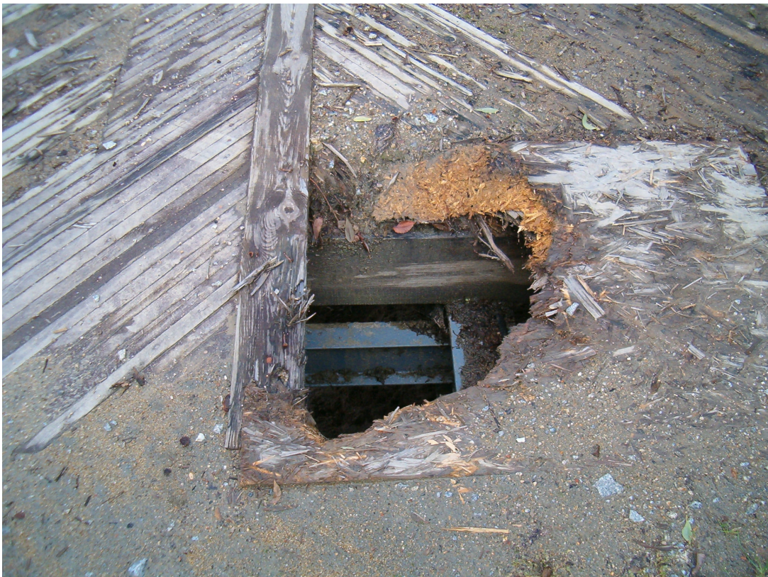
Z-2 Uszkodzenie jezdni drewnianej przy przyczółku.
