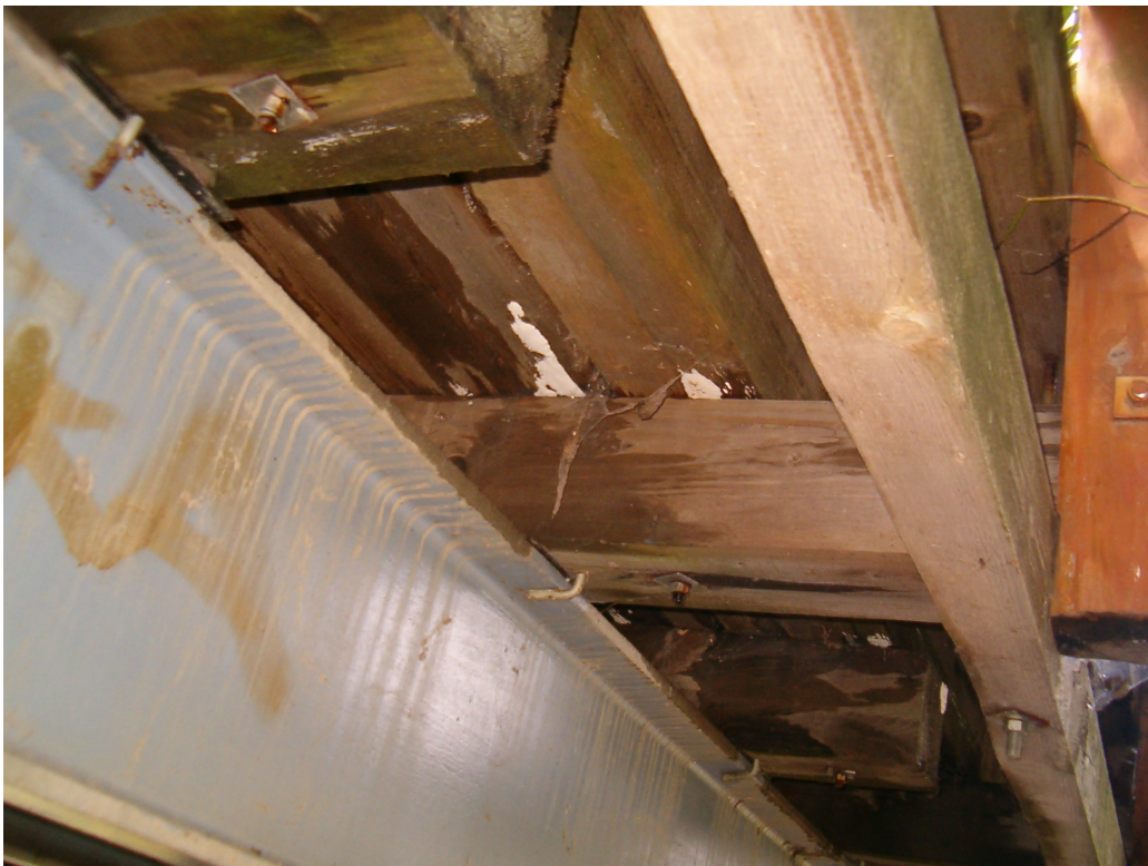
Z-8 Widoczne zawilgocenie i zagrzybienie elementów pokładu dolnego i belek poprzecznych.
