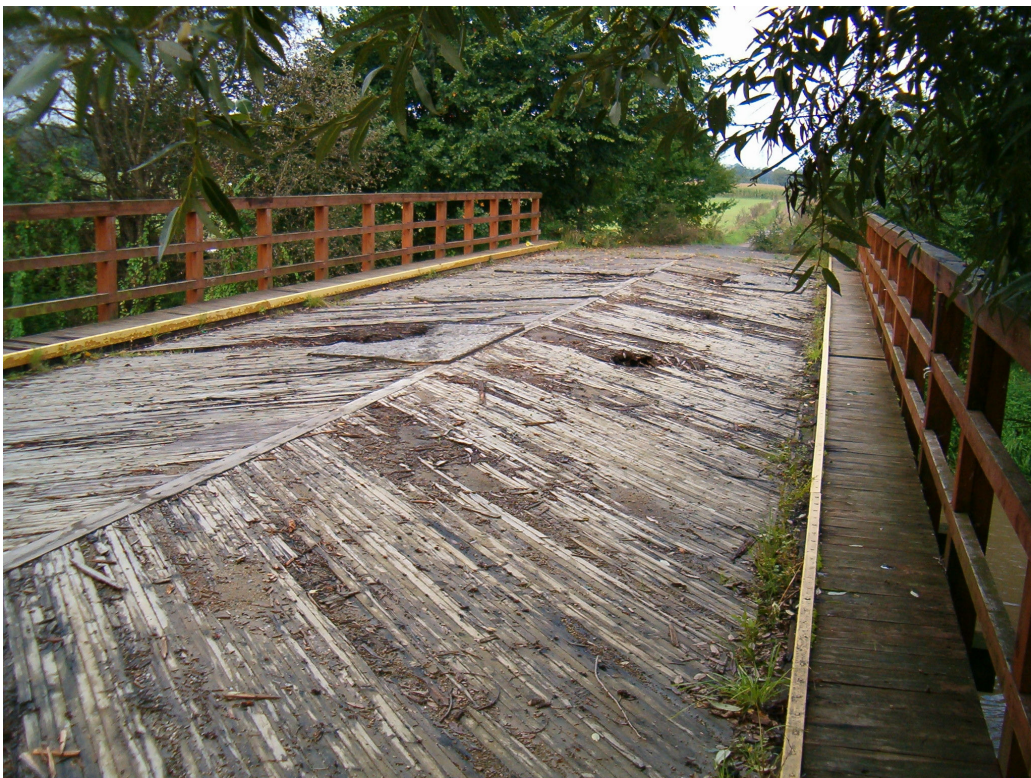
Z-4 Widoczne uszkodzenia jezdni w części środkowej mostu
