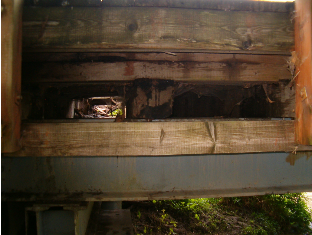
Z-7 Widoczne zwilgocenie i uszkodzenie elementów drewnianych mostu.
