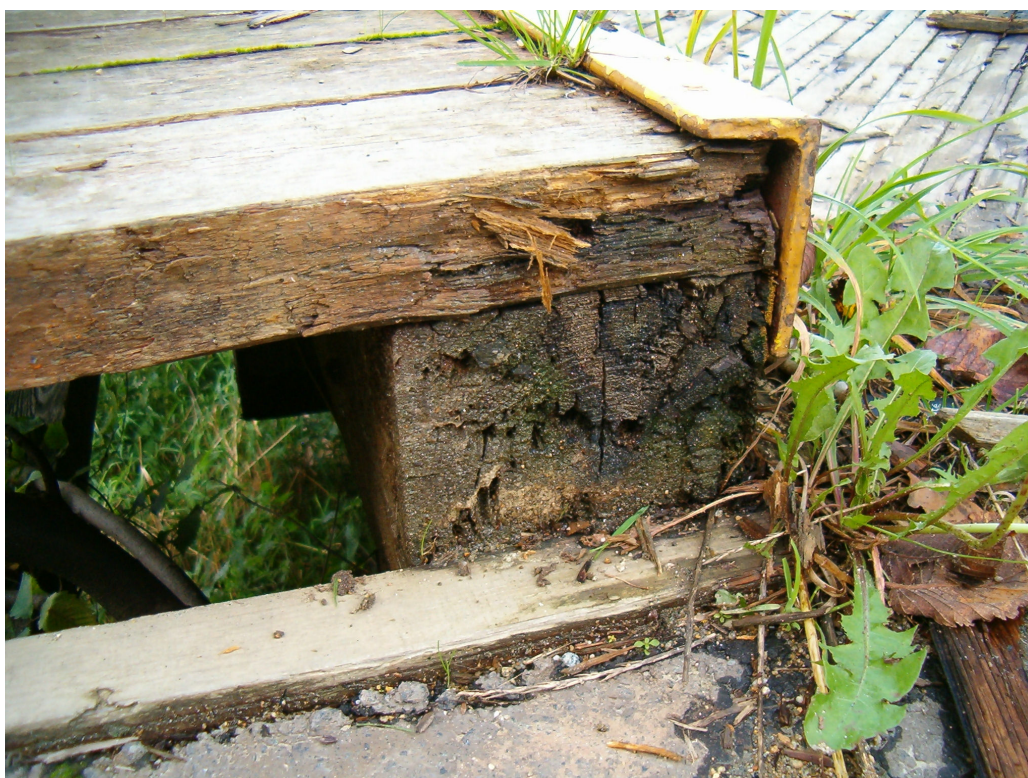
Z-10 Uszkodzone elementy opaski bezpieczeństwa.
