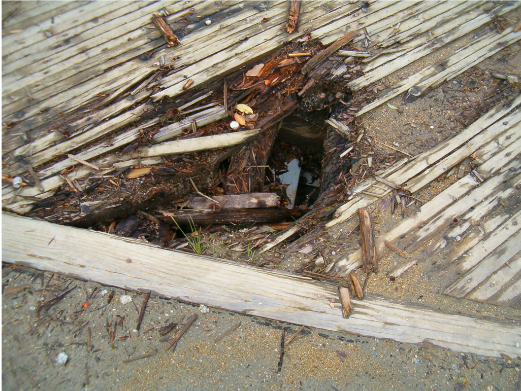
Z-3 Zniszczona jezdnia w strefie przypodporowej.
